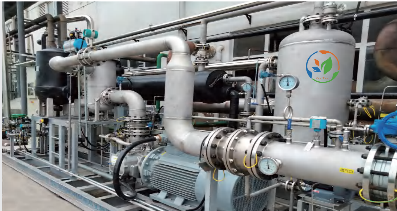
图一 500Nm³/h丙酮尾气回收设备现场照片
