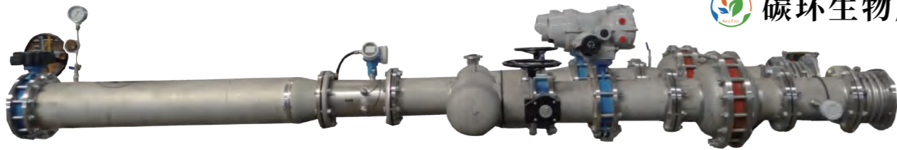
图十八 VOCs燃烧火炬废气管路
