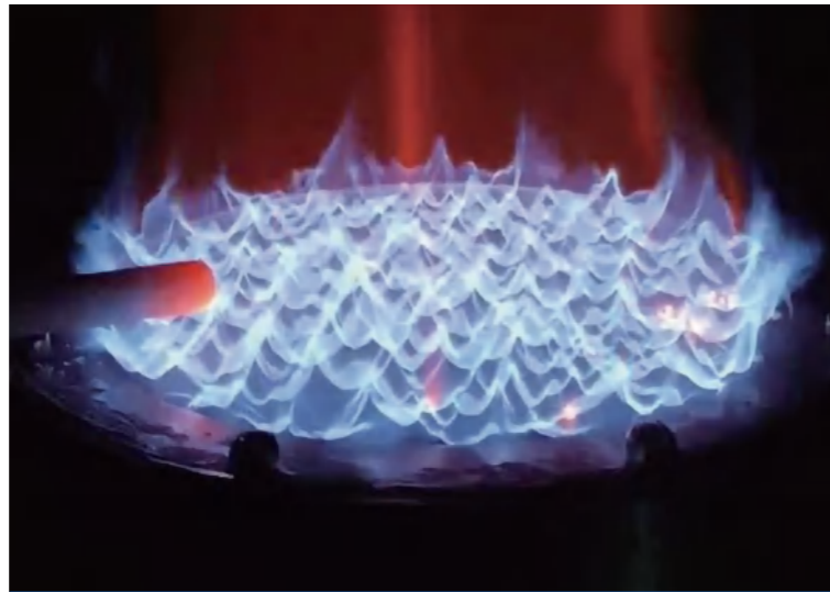
图十七 CCTV视频监控下的防爆火炬燃烧状态
